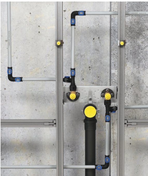
▲ Damit Kaltwasser kalt bleibt, hat sich für den Armaturenanschluss die MasterFix-Anbindung von Geberit bewährt.
