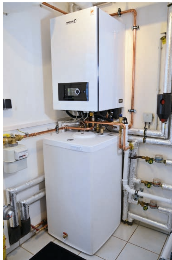
▲ Die Hybridanlage mit Wärmepumpe und Gasbrennwertkessel von Brötje ersetzte den Niedertemperatur-Ölheizkessel. Unten im Bild ist der 160 l fassende Trinkwasserspeicher BS 160 C zu sehen.
