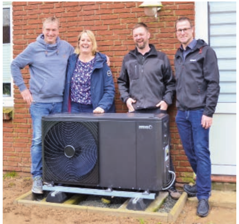
▲ Zufriedene Gesichter (von links): Stefan und Bianka Rahn, Heizungsbau-Meister Klaas Ewertsen und Brötje Vertriebs-Außendienst Hendrik Simon Lütje.
