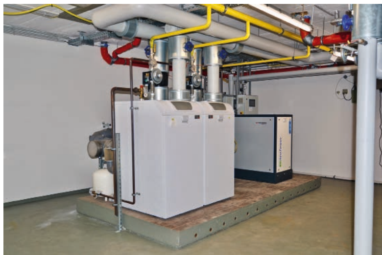
◀ Die zwei Gas-Brennwertkessel tragen die Hauptlast der Wärmeerzeugung, das BHKW im Hintergrund deckt die Grundlast an Wärme und Strom.
