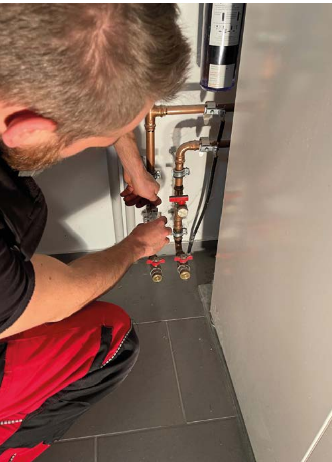
Bild 1 • Die vorgeschriebene Wasserprobe wird direkt am Rücklauf genommen.
