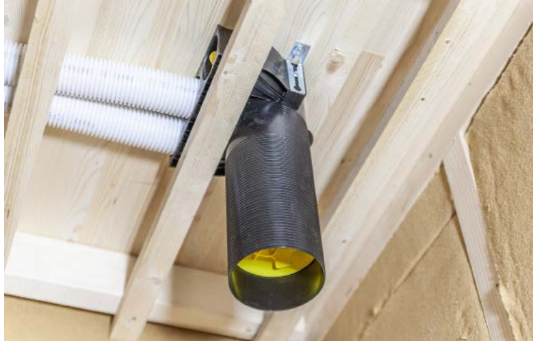
Bild 2 • Die profi-air-Luftdurchlässe für das profi-air classic-Rohr konnte der Installateur in Königsberg universell für Zu- und Abluft einsetzen.
