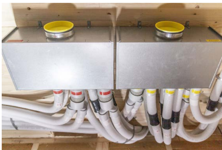
Bild 3 • Mit dem profi-air classic-Verteiler plus für Zu- oder Abluft lassen sich die Rohre im Einfamilienhaus an das Lüftungsgerät profi-air 250 flex anschließen.
