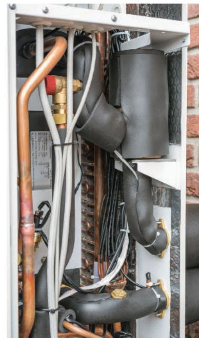
▲ Außengerät der Basic Line Air Bloc mit Sicherheitsventil (o. l.), Gasabscheider (o. r.) und Rückschlagkappe (unten).
