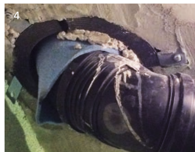
Bild 4 • Manschette falsch, da um 180 Grad verdreht eingebaut.
