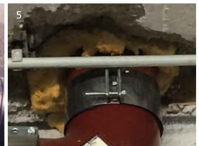
Bild 5 • Falsch ausgeführter Verschluss, da der Ringspalt unzulässig verfüllt wurde.
