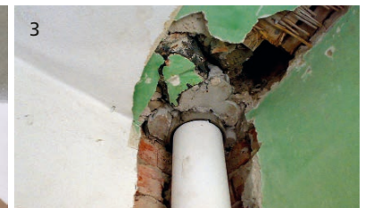
Bild 3 • Unzureichend ausgeführter Verschluss.
