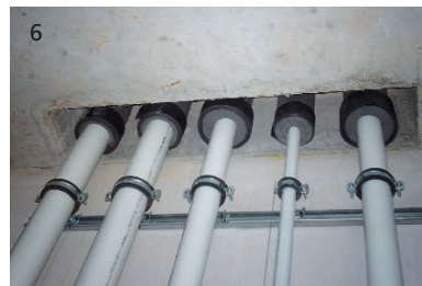
Bild 6 • Die Durchführungsöffnung passt.
