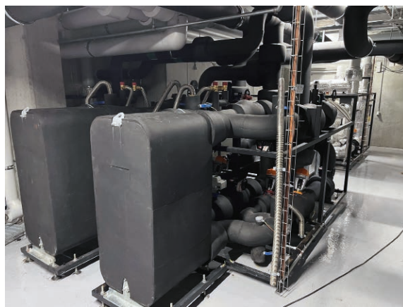
▲ Bild 4 • Fernkälteanlagen gewährleisten das ganze Jahr über einen hohen Komfort.
