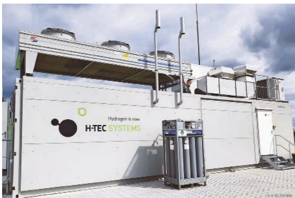
Bild 1 • Beispiel: Windenergie wird in Haurup mit dem PEM-Elektrolyseur ME450 der H-TEC SYSTEMS in grünen Wasserstoff umgewandelt.
