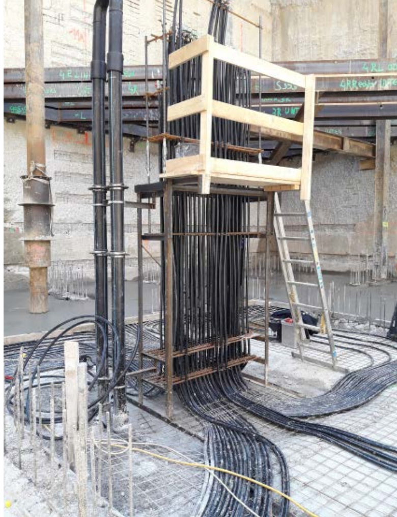
Bild 2 • Der Verteilerbereich einschließlich Hochführung der Anbindungsleitungen. Die Geothermie-Rohrleitungen werden durch die Abdichtebene geführt und nach dem Betonieren der Bodenplatte mittels dauerelastischem Injektionsgel unter Hochdruck abgedichtet.
