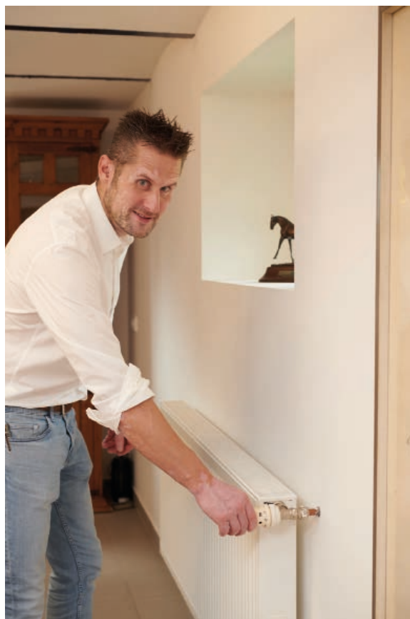
Bild 6 • Tobias Galmbacher berichtet, dass sich die Wärmepumpen ohne Komfortverlust mit den im Schlossgut verbauten, konventionellen Heizkörpern betreiben lassen.
