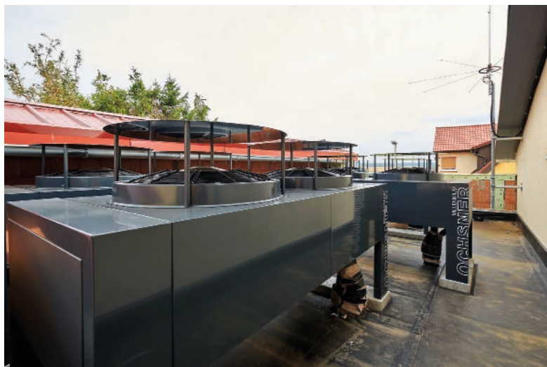
Bild 4 • Die laufruhigen Tischverdampfer sind auf dem Dach des neuen Gebäudes für die Wärmepumpenanlage installiert.
