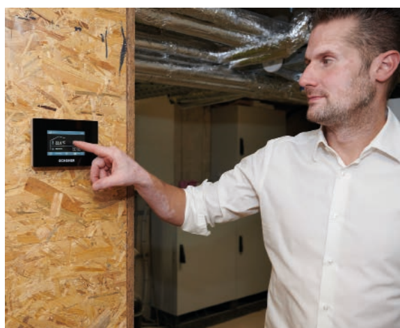
Bild 7 • Mit der elektronischen Steuerung und der Unterstützung des Kundendienstes von Ochsner konnte Tobias Galmbacher die Wärmepumpenanlage genau auf seine Vorstellungen abstimmen.
