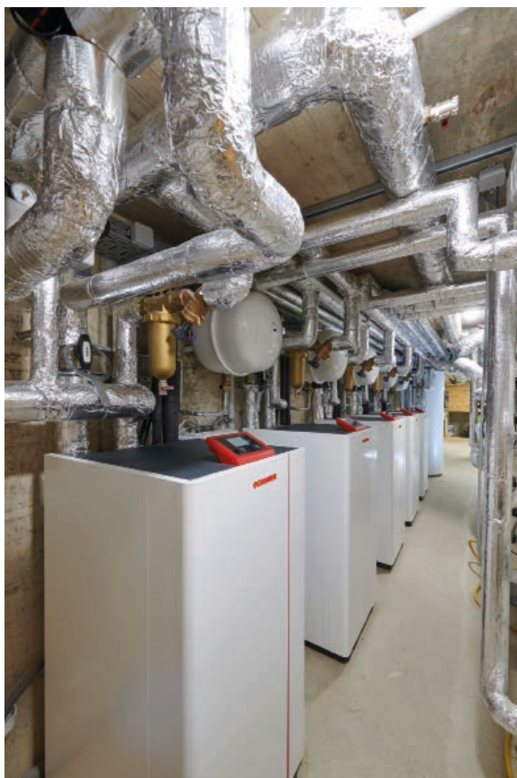
Bild 5 • Vier Wärmepumpen des Typs Ochsner Air 41 versorgen Haupthaus und Nebengebäude mit Wärme. Ein fünftes Modell des gleichen Typs ist als Sicherheitsbackup installiert.
