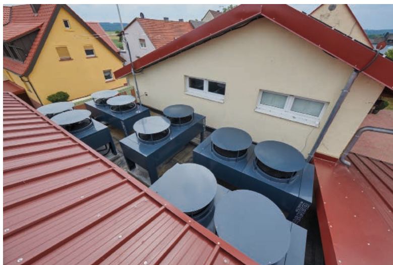
Bild 3 • Fünf Verdampfeinheiten mit je zwei Tischventilatoren liefern die Wärme für die Luft/Wasser-Wärmepumpen.
