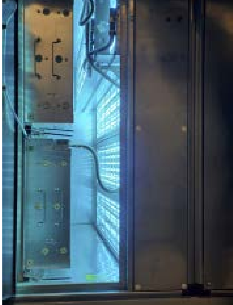
Bild 5 • Bestrahlungswand für RLT-Anlage.
