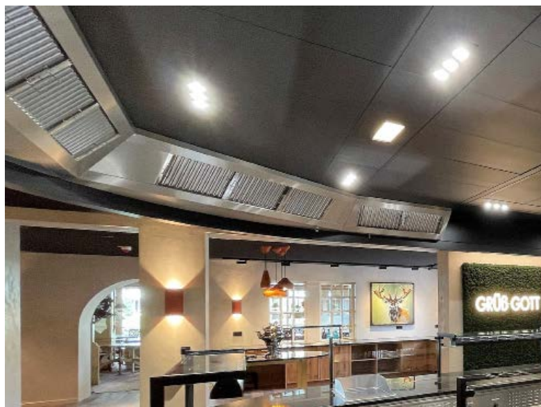
Bild 3 • Halbrunde Lüftungsdecke mit X-Cyclone-Abscheidern.
