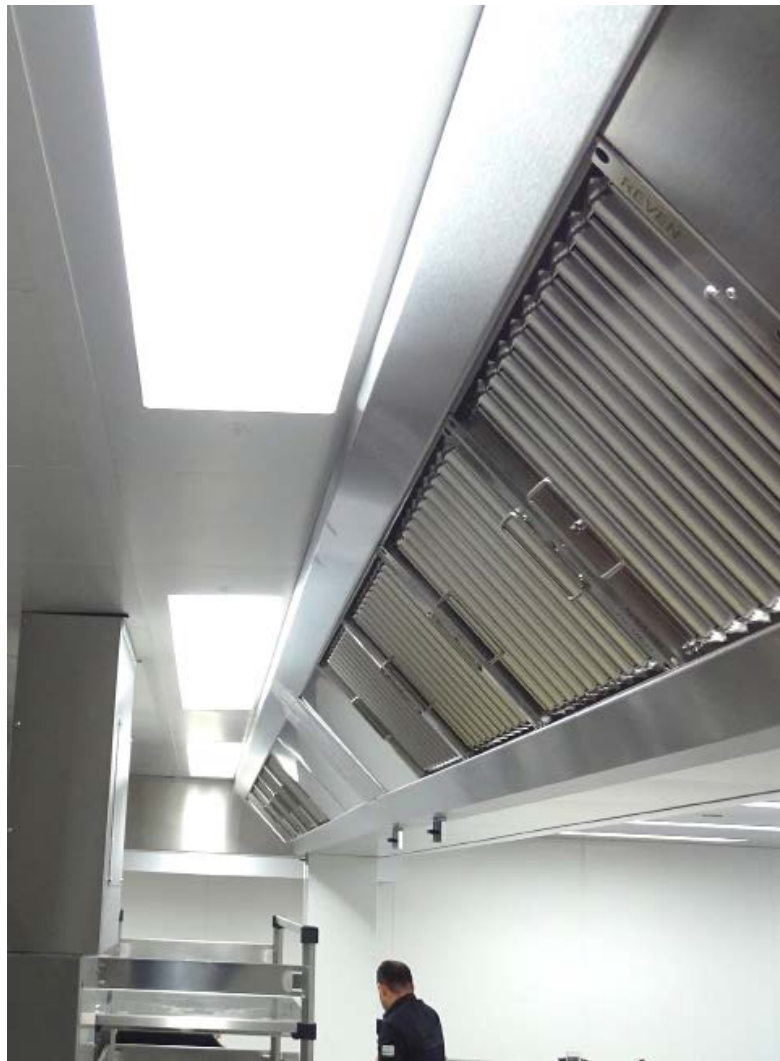
Bild 2 • Hotelküche mit integrierter VA-Lüftungsdecke.
