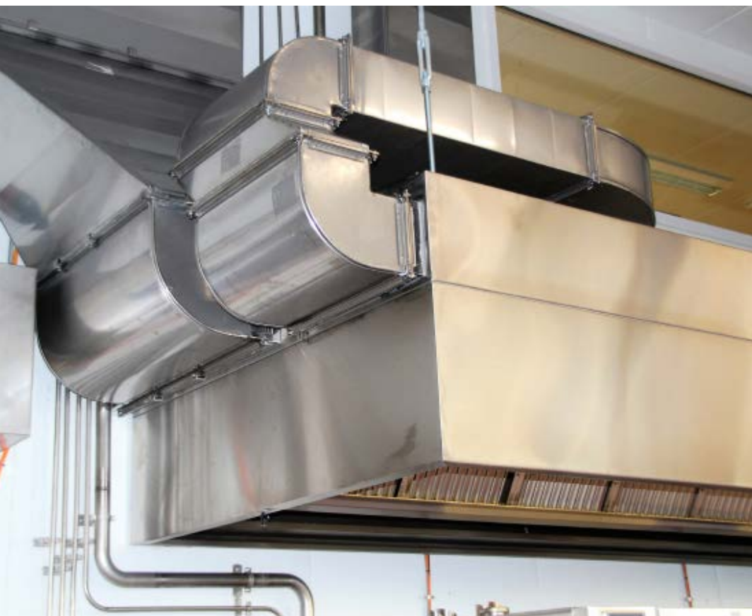
Bild 1 • Alte Abzugshauben sind oft Schmutzfänger.
