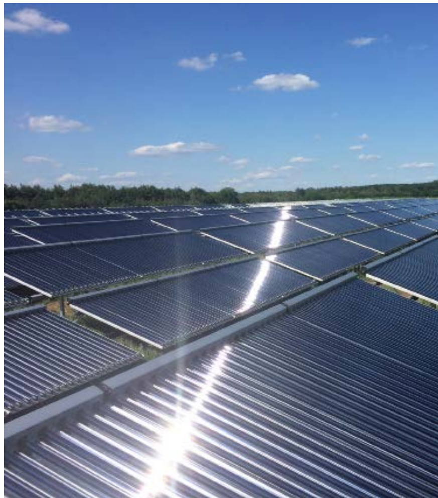
Bild 1 • Kollektorfeld für Fernwärme in Senftenberg
