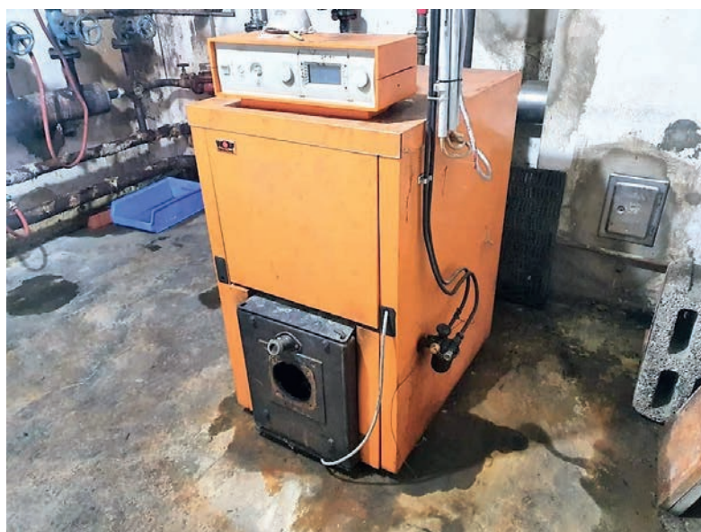
Bild 9 • Der alte Ölkessel aus dem Jahr 1994 hatte eine Nennheizleistung von 65 kW. Alle Bilder: Remeha
