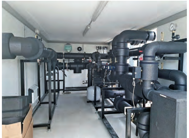
Bild 4 • Blick in das Innenleben der Betonraumzellen. Diese sind ortsveränderlich und lassen sich im Bedarfsfall jederzeit an einen neuen Standort versetzen.
