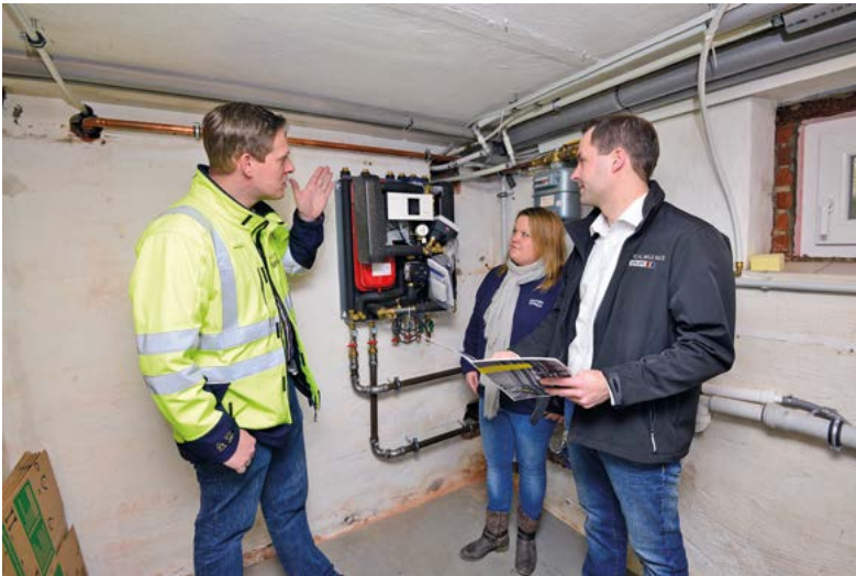
◀ Bild 2 • Mit einer umfassenden Informationskampagne stellen Projektleiter Thomas Ogsoka und Dipl.-Ing. Päivi Anneli Mittenentzwei (v. l. n. r.) hier im Gespräch mit Viega Key Account Manager Sebastian Müller) den Hausbesitzern die Vorzüge der regenerativ erzeugten Fernwärme vor – und stoßen damit gerade in Objekten mit alten, konventionellen Heizanlagen durchweg auf offene Ohren.
