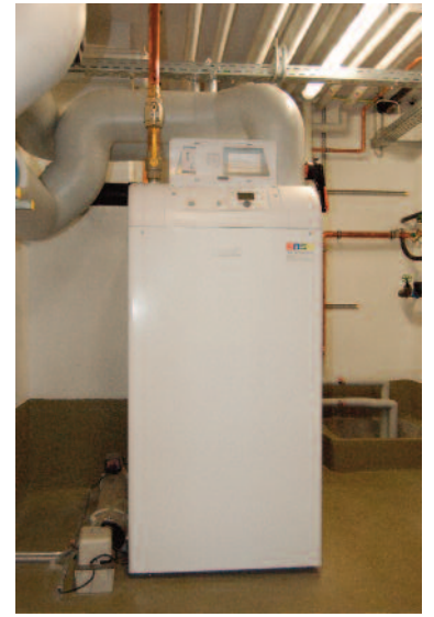
▲ Bild 4 • Der Brötje SGB 170 versorgt die Verkaufsräume sowie die Büros, Sozialräume und Werkstätten mit angenehmer Heizwärme.
