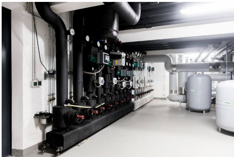
Im Heizungskeller der Zukunft sorgen die Wilo-Stratos MAXO für die Beheizung und Klimatisierung des Neubaus.
