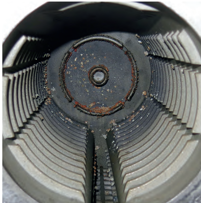
Bild 3 • Brennkammer des Öl-Brennwertkessels WTC-OB nach einer Laufzeit von ca. 5.000 Betriebsstunden mit GtL. Bild: Shell
