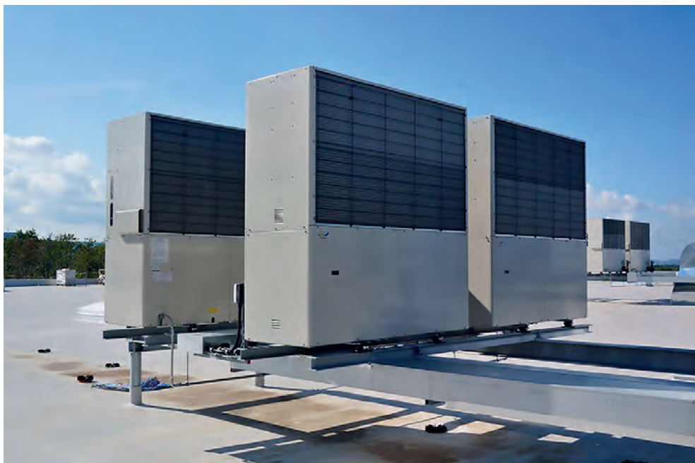
Bild 4 • Gasmotoren-Wärmepumpen der Logistikhalle von Zalando in Lahr/Schwarzwald. Bild: KCU CONCEPT GmbH
