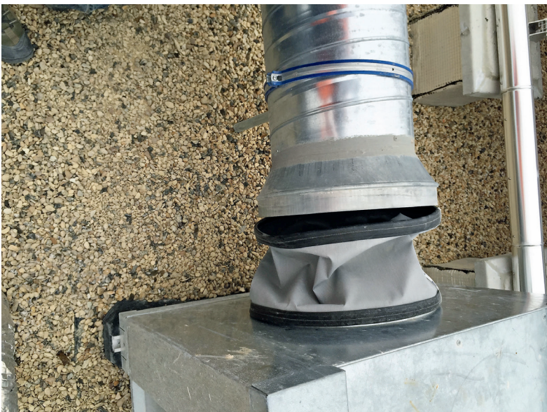
▲ Bild 6 • Leckagen sind oft auch an Verbindungen unterschiedlicher Luftleitungskomponenten zu finden, die nicht sorgfältig und fachgerecht ausgeführt wurden.
