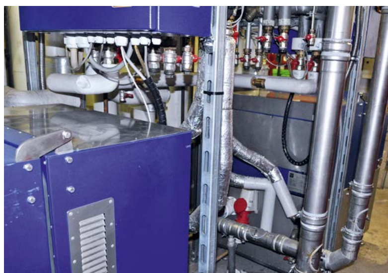
▲ Bild 6 • Normalerweise gehört zu den XRGI-Einheiten ein Wärmeverteilungsmodul. Das Installieren gestatteten die Verhältnisse im Caritas-Haus nicht. Die Anlagenbauer mussten sozusagen in Handarbeit die beiden Einheiten an den Wärmeverteiler anschließen.
