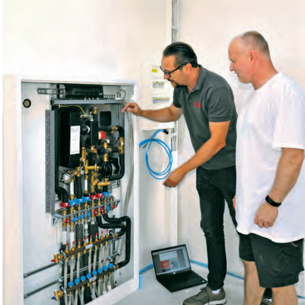
Bild 2 • Von links: Manuel Kühnert von Roth mit SHK-Fachhandwerker Kai Wichelmann bei der Einstellung der Roth Wohnungsstationen FlatConnect.
