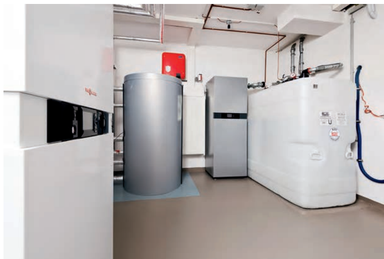
◀ Bild 2 • Blick in den Heizungskeller des Innovationshauses (v. l.): Hybridgerät, Warmwasserspeicher, Stromspeicher sowie der Tank für Heizöl und neue, flüssige Brennstoffe.
