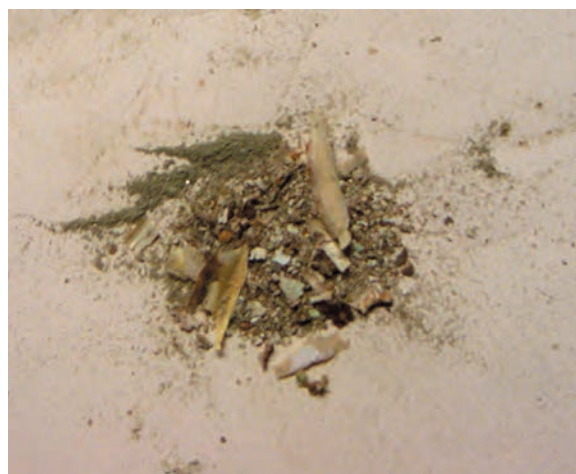
Bild 2 • Die Menge der von einem Ventil entfernten Verkrustungen.
