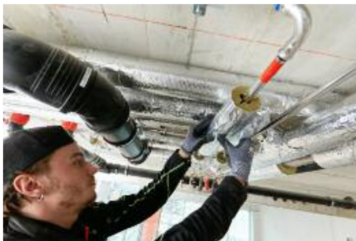
◀ Bild 3 • Die Dämmung der Kälteleitungen erfolgte mit der „TECLIT PS Cold“-Rohrschale aus konzentrisch gewickelter Steinwolle. Genauso wie die Dämmung im „TECLIT Hanger“ sind auch die Rohrschalen mit einer besonders stabilen, glasfasernetzverstärkten Alukaschierung versehen. Die Rohrschalen werden aufgeklappt und einfach um die Kälteleitungen gelegt.
