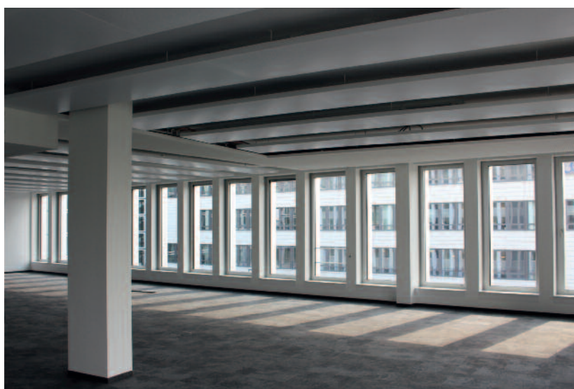
◀ Heiz-Kühl-Deckenelemente in einem Büroraum.
