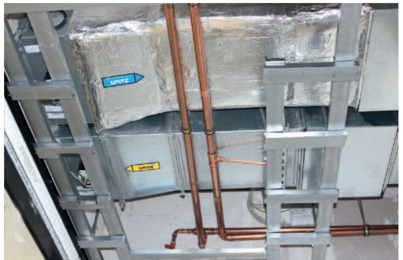
▲ Anbindeleitungen für die Versorgung in der Cafeteria.
