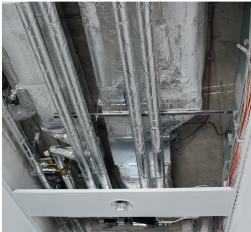
◀ Bereits isolierte Deckenleitungen mit Kupferrohren.
