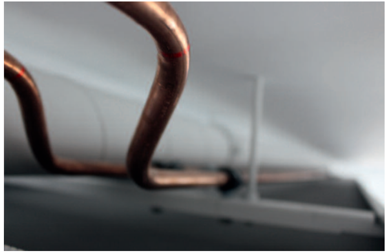
▲ Detailaufnahme: Kupferrohr in Heiz-Kühl-Decke integriert.
