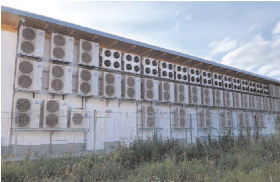
◀ Bild 9 • Stabilisierung der Energieautarki mit einer weiteren technischen Innovation: 2015 wurde das Regionale Regelkraftwerk RRKW in Betrieb genommen. Mit einem 10 MW-Lithium-Ionen-Akku sichert es die Vollversorgung des Dorfes und kompensiert Schwankungen in der Netzfrequenz des Übertragungs-Netzbetreibers.
