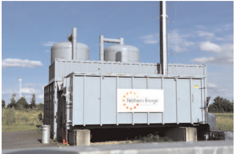
▲ Bild 6 • Zusatzwärme aus dem Holzhackschnitzelkessel, sollte an ganz kalten Tagen das BHKW nicht genügend Nahwärme für die Wohnhäuser und den Zuchtbetrieb bereitstellen.
